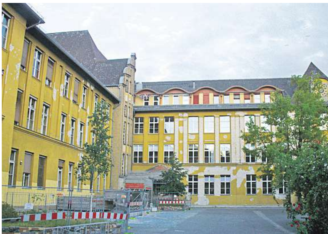
Symbol für Versagen im Hochbauamt: An der Oberschule am Fichtenberg blättert nicht nur der Putz ab. Der Bau ist rundherum renovierungsbedürftig.
