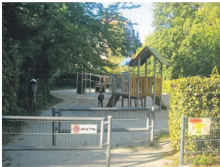
Dem Spielplatz an der Schönower Straße fehlt ein Zauntor, damit Kinder nicht einfach auf die Straße laufen. Foto: M. A. Schmidt
